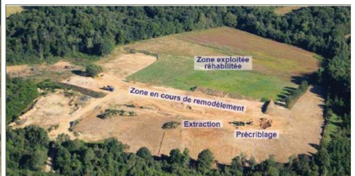
Restauration paysagère concomitante à l'avancée des travaux (source : Imerys, site de St-Paul-la-Roche)
